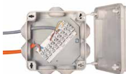
Boîtier avec les câbles
